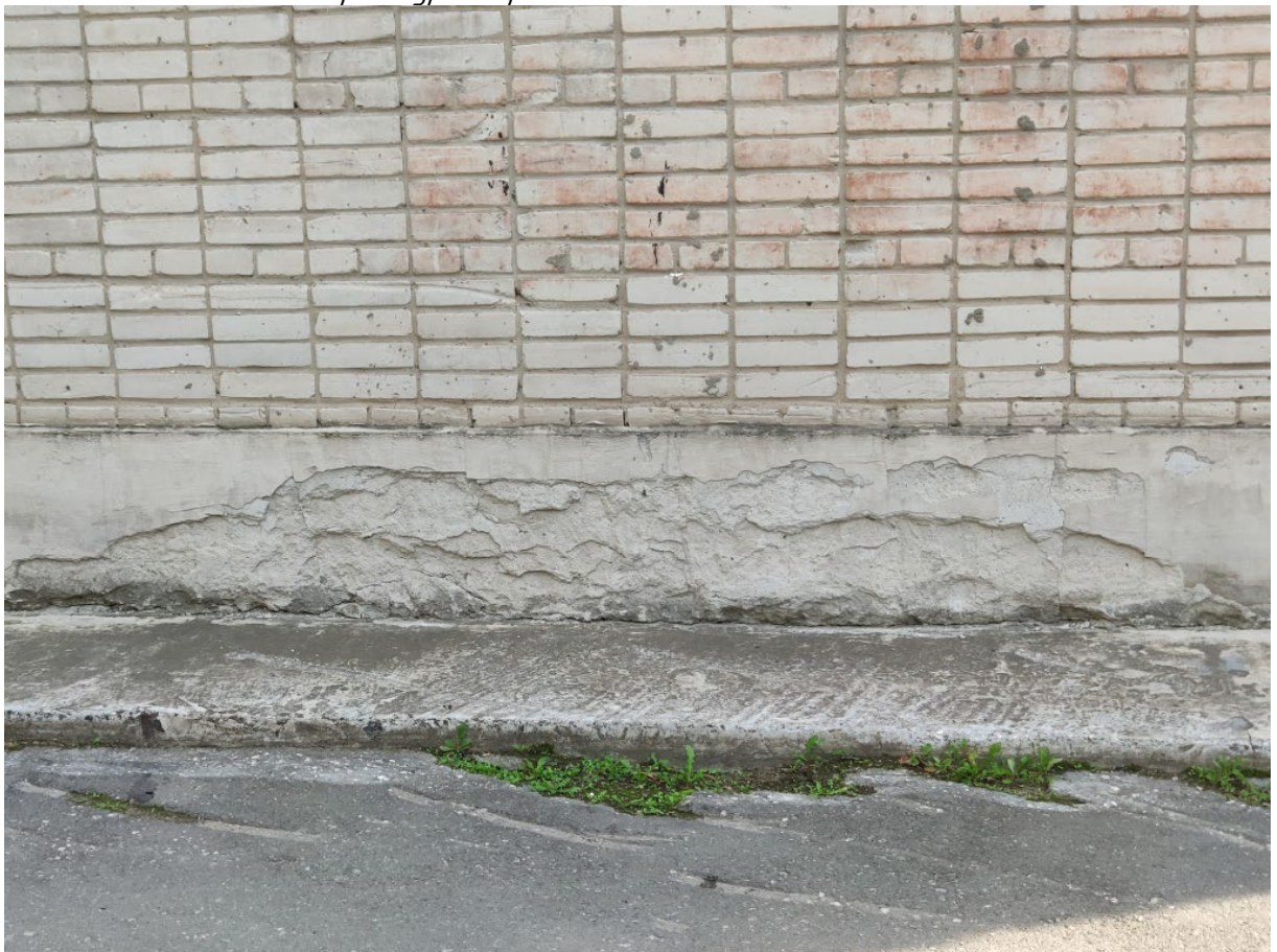
Фото 22. Разрушение декоративного штукатурного слоя цоколя
