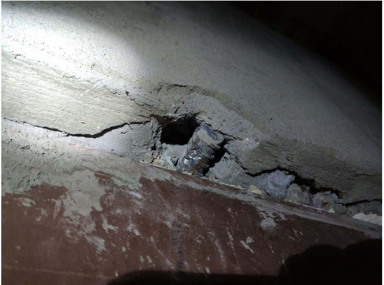
Фото 103. Контрольное вскрытие системы рабочего армирования многопустотных плит перекрытия и покрытия в осях 2-10/Б-Д
