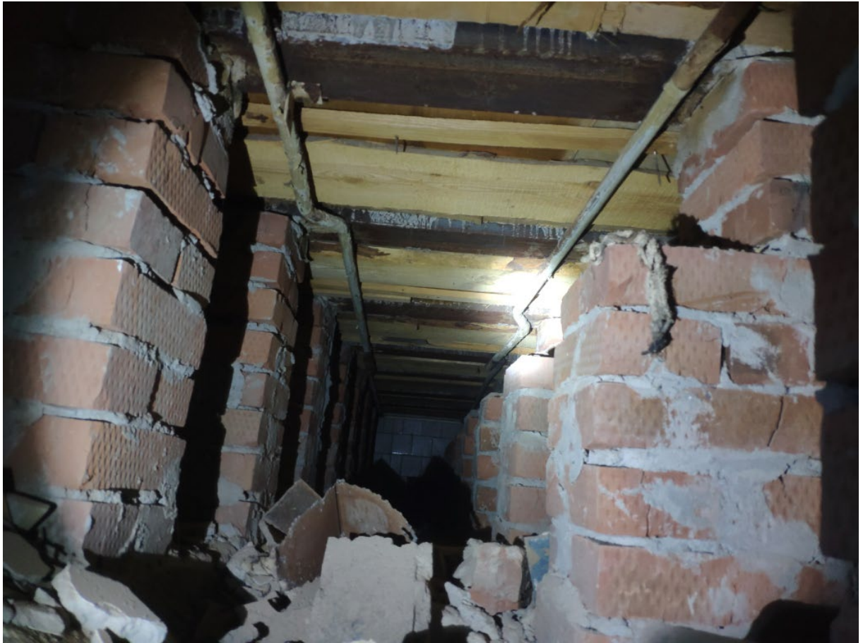
Фото 161. Деревянный настил по кирпичным столбикам стального балочного перекрытия подвала в осях 6-8/Б-В. Общий вид
