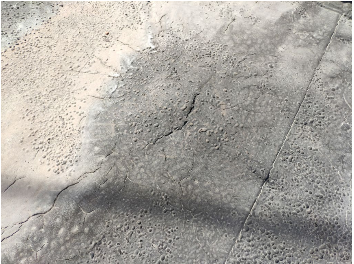
Фото 52. Механические повреждения (порезы, отверстия) гидроизоляционного слоя кровли
