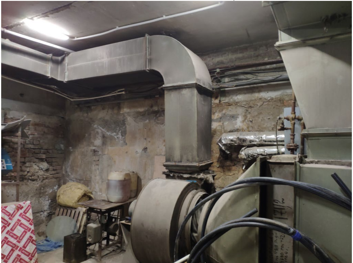
Фото 84. Следы замачивания и высолы и разрушение отделочного штукатурного слоя стен подвала стен подвала в осях 8-10/Б-В
