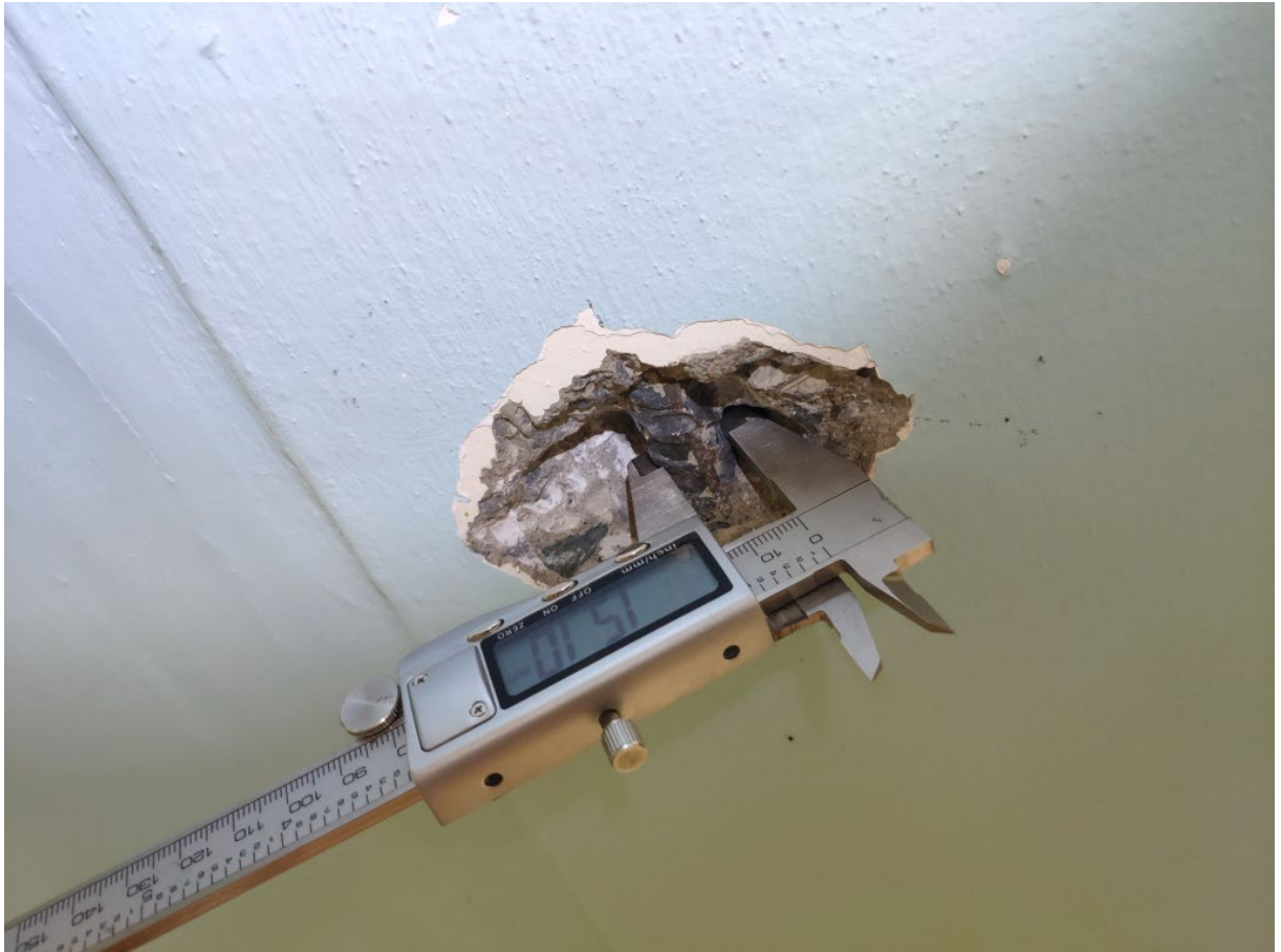
Фото 105. Контрольное вскрытие системы рабочего армирования многоспустотных плит перекрытия и покрытия в осях 2-10/Б-Д
