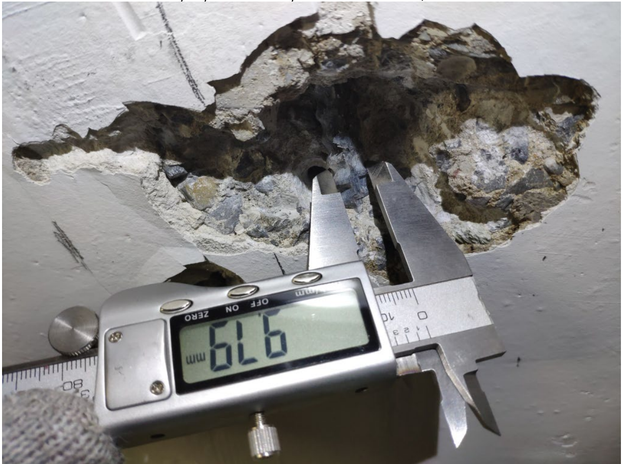
Фото 106. Контрольное вскрытие системы рабочего армирования многоспустотных плит перекрытия и покрытия в осях 2-10/Б-Д
