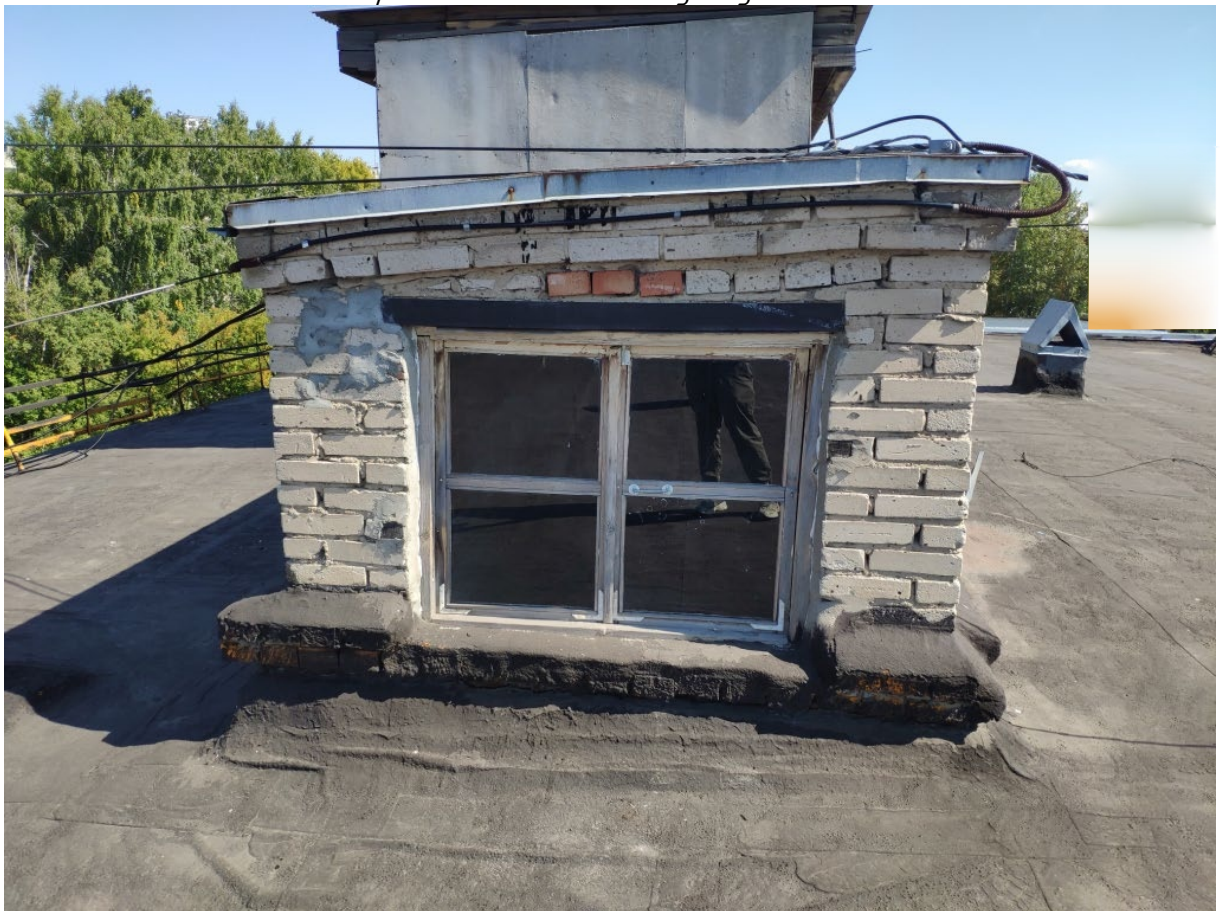
Фото 62. Недостаточная зона опирания стальной оконной перемычки выхода на кровлю в осях б/Г-Д
