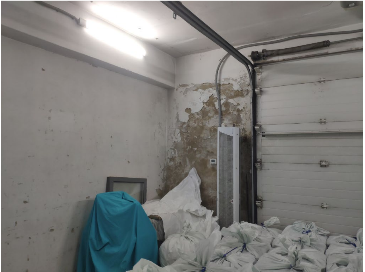
Фото 163. Следы замачивания и разрушение отделочного штукатурного слоя стен 1-го этажа в осях 5/Е
