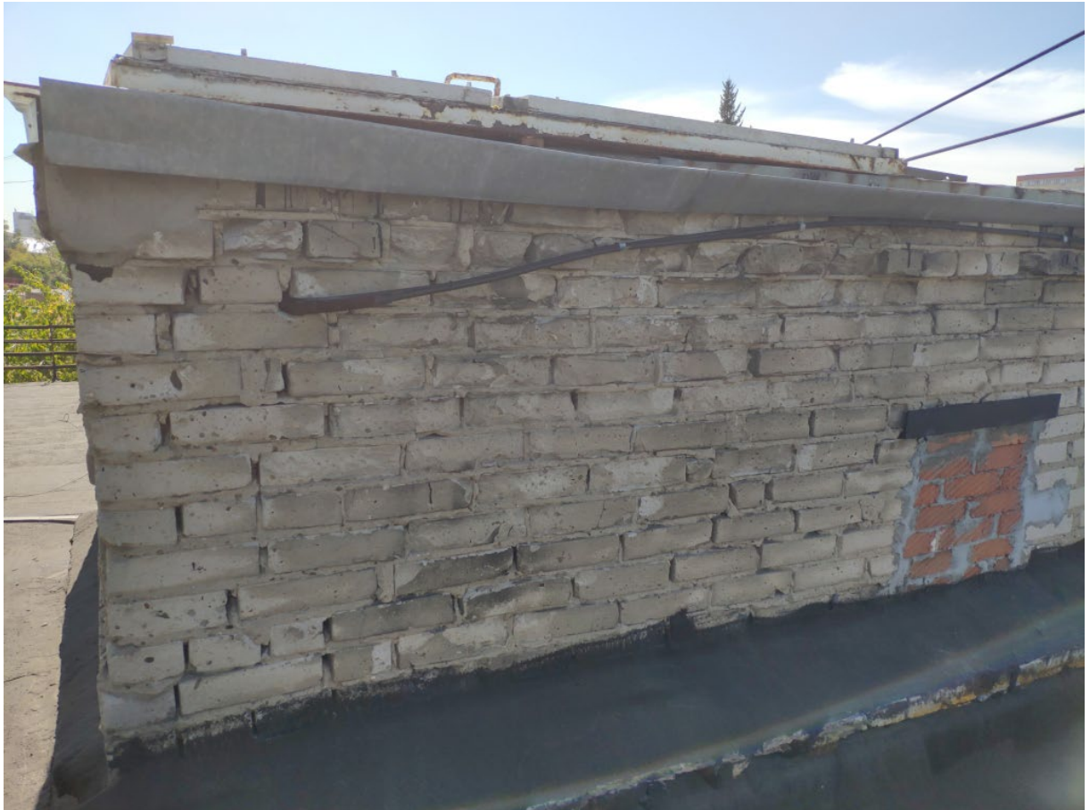
Фото 61. Следы замачивания и высолы на поверхности наружных стен и деструкция кирпичной кладки на глубину до 35мм
