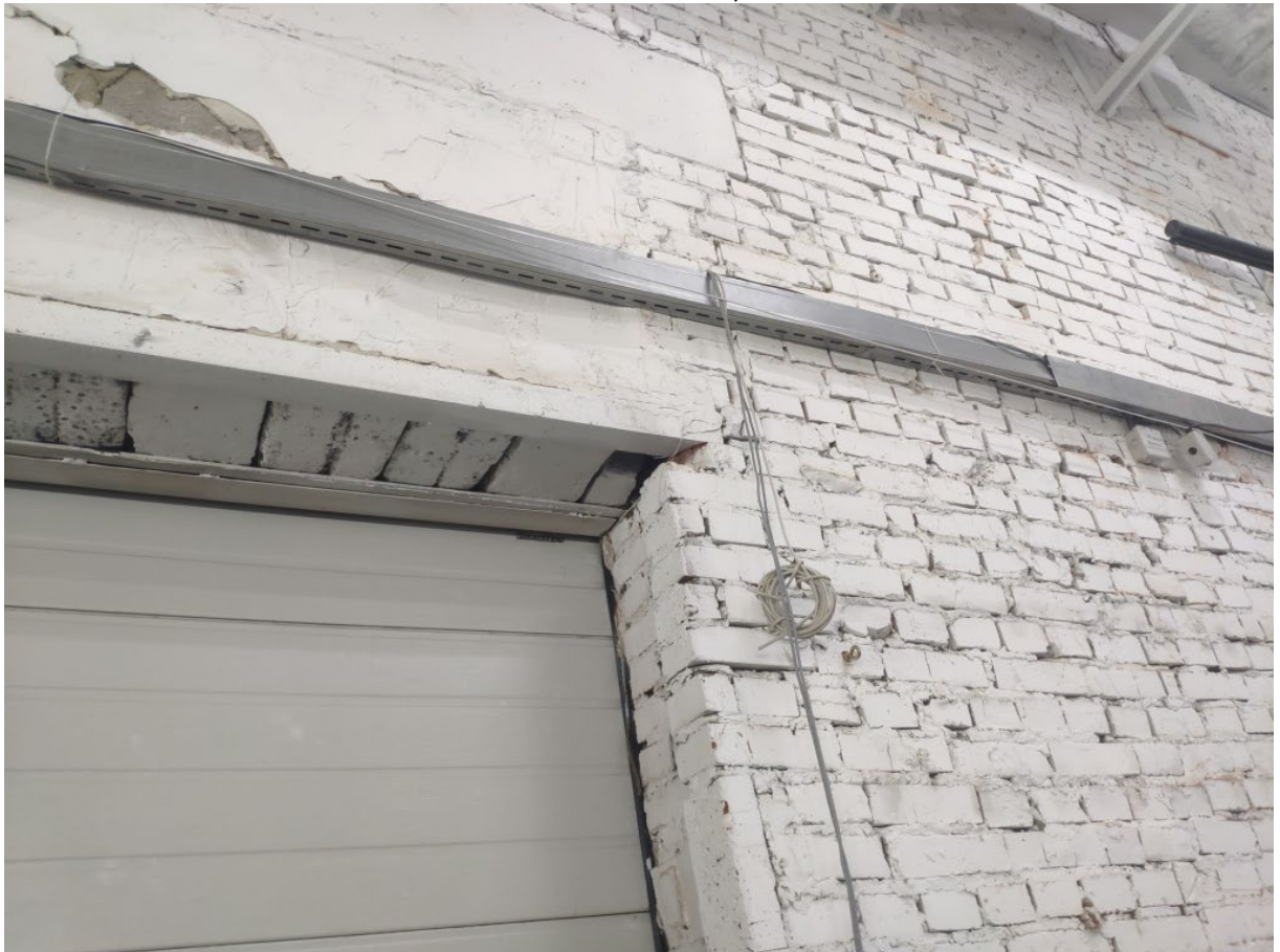
Фото 164. Недостаточная зона опирания стальной перемычки ворот в осях 3/Д-Е
