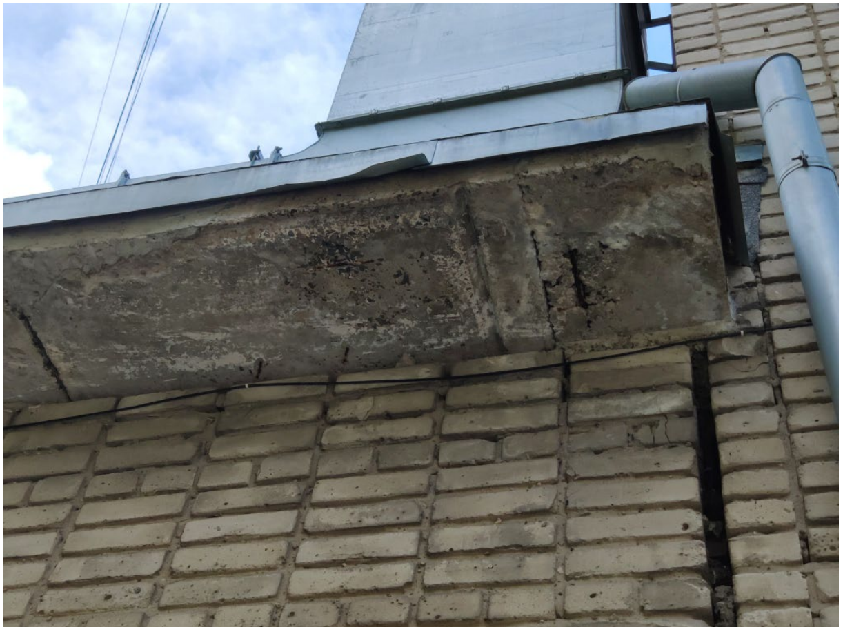
Фото 21. Непровидимые участки бетона карнизных плит и III стадии коррозии арматуры карнизных железобетонных плит
