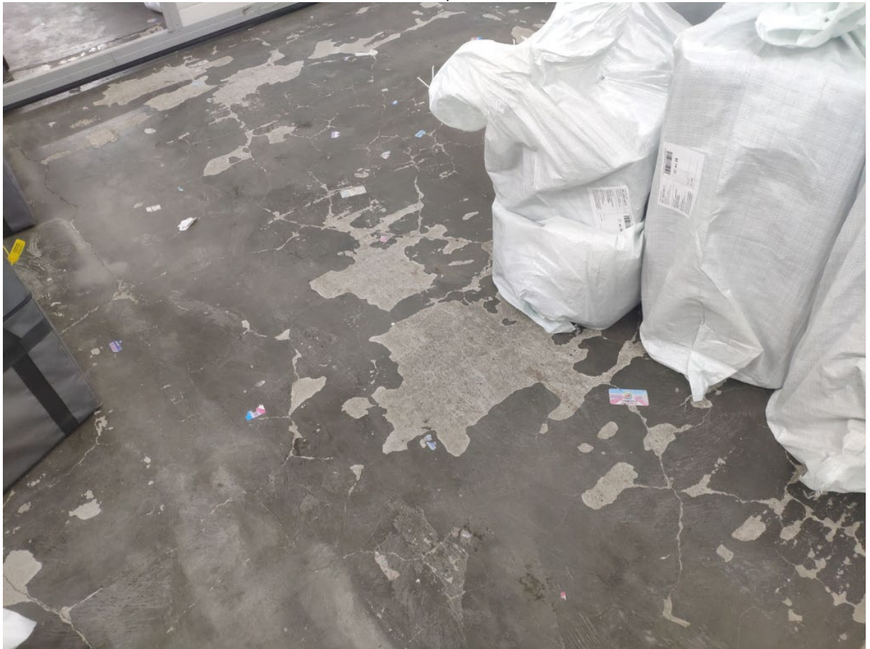
Фото 162. Шелушение и отслоение полимерного покрытия, а также сеть трещин в бетонном полу 1-го этажа в осях 3-5/Д-Е
