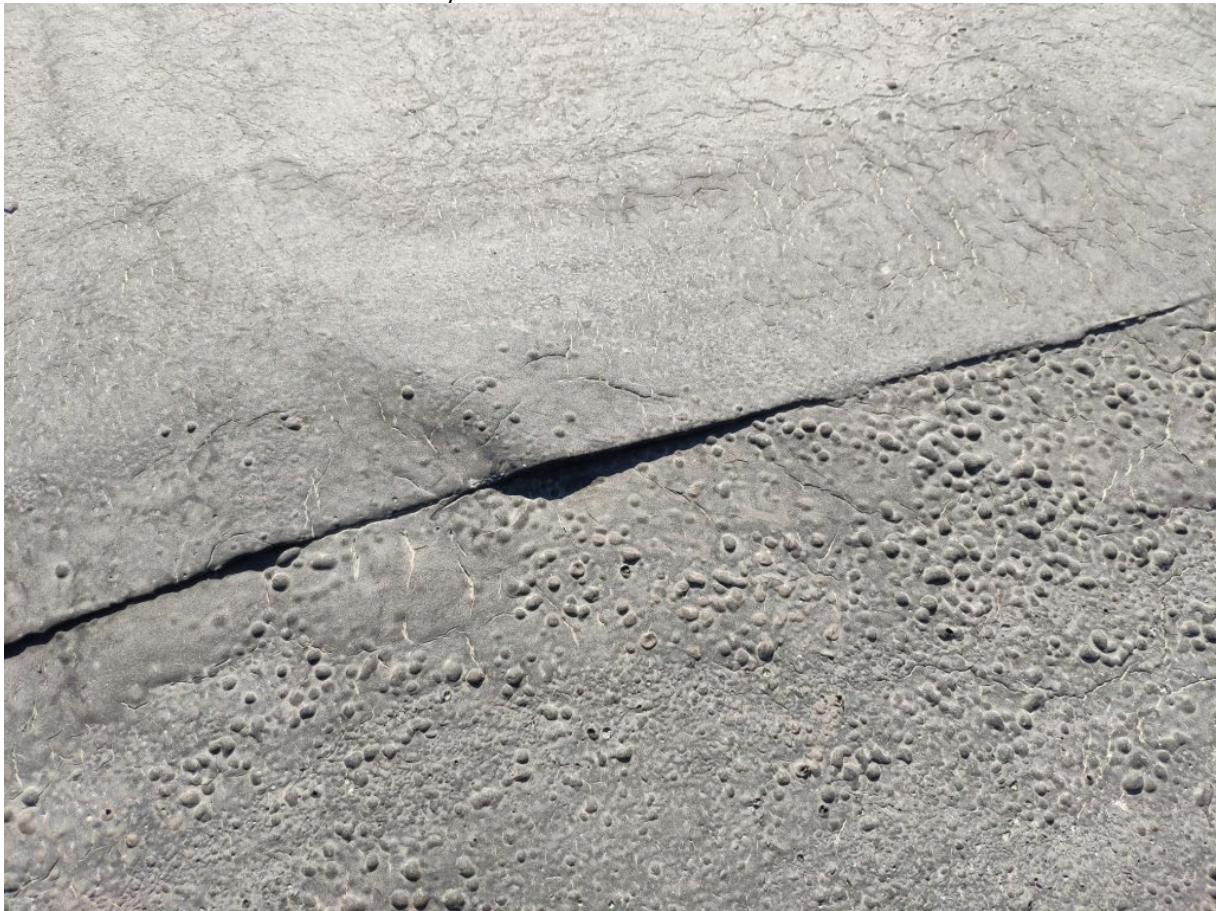
Фото 60. Отслоение и вздутие гидроизоляционных слоев кровли
