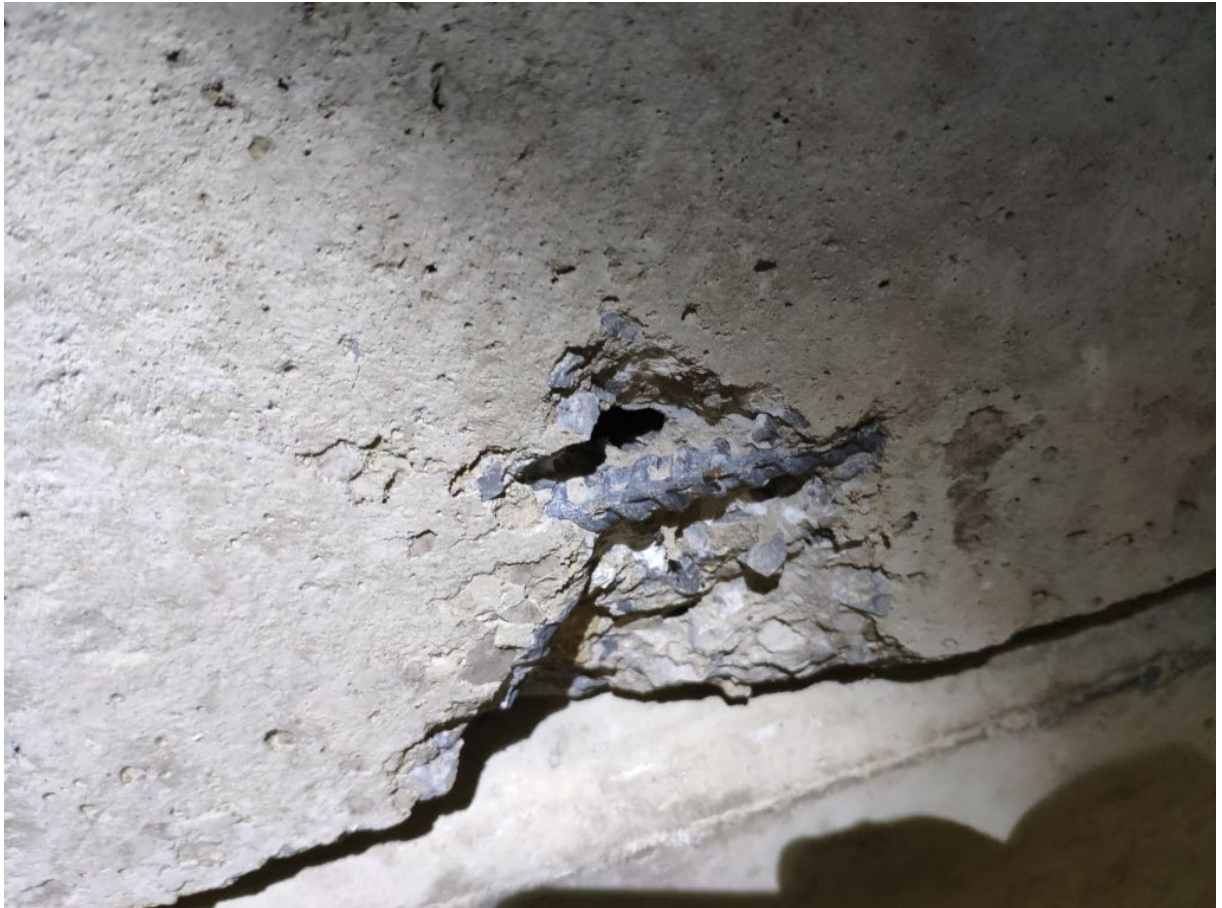
Фото 93. Контрольное вскрытие системы рабочего армирования многопустотных плит перекрытия и покрытия в осях 2-10/Б-Д
